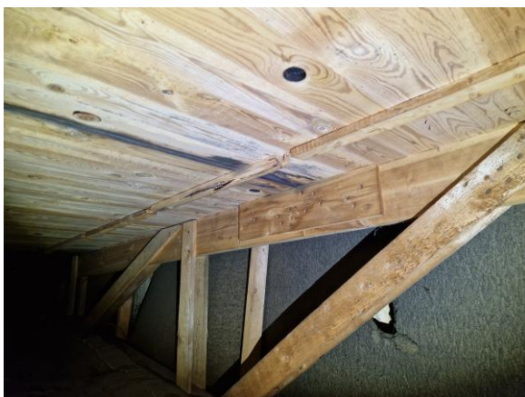
Visar vind-lokala fuktgenomslag och mikrobiell påväxt på underlagstaket.
