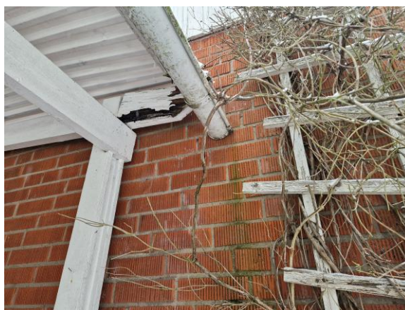
Rötskadad takstol där hängrännen lutar mot huset.
