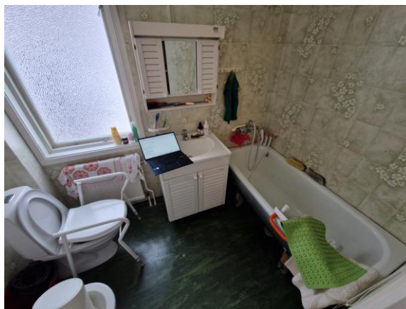
Äldre våtutrymme på entréplan, behov av renovering.
