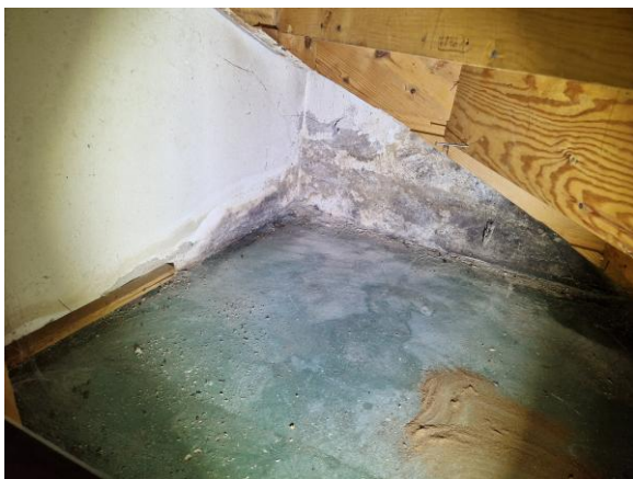
Fuktgenomslag på yttervägg under trappan.
