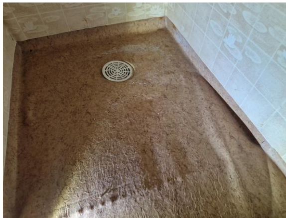
Mattsläpp idusch i källare.
