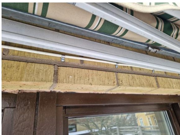
Sprickor i fasaden över fönster.
