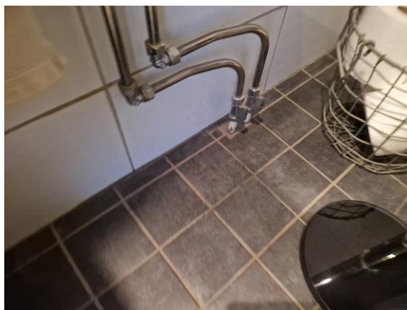
Rör genomföringar i golv i våtutrymmet.
