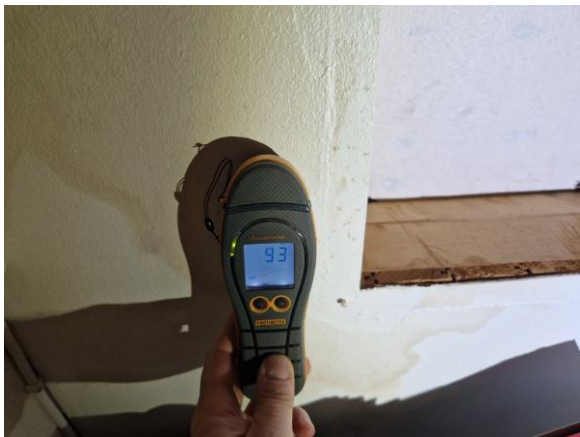
Visar fuktmarkeringar på undertaket i förrådet på entréplan. Inga avvikelser noterades vid fuktindikering.
