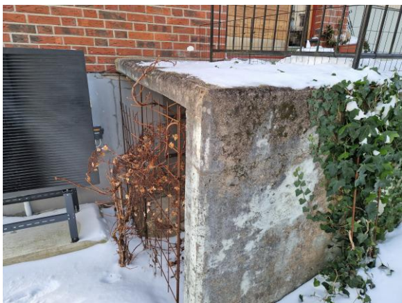
Visar entrétrappa som satt sig/lutar utåt.
