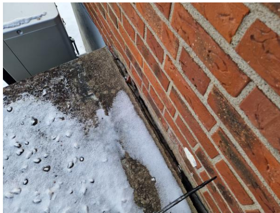
Visar entrétrappa som satt sig.
