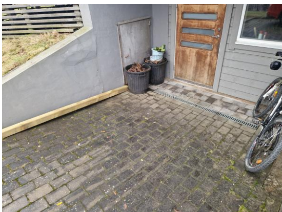
Visar sprickor/putssläpp grunsmur vid källaretrén
