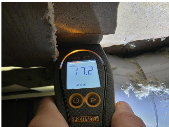
Pågående läckage, lokalt vid avlopp under dusch/wc.
