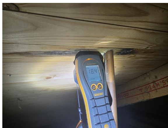
Lokalt pågående läckage vid takgenomföring ovanför det gamla expansionskärlet pånockvinden.
