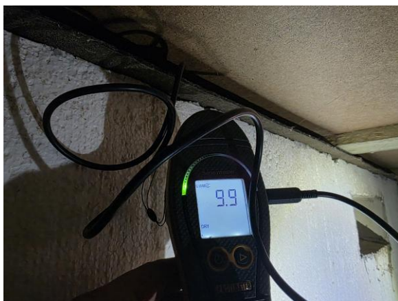
Fuktkvoten uppmättes i yttervägssyll till 10% vilket är under kritisk gräns för mikrobiell tillväxt.
