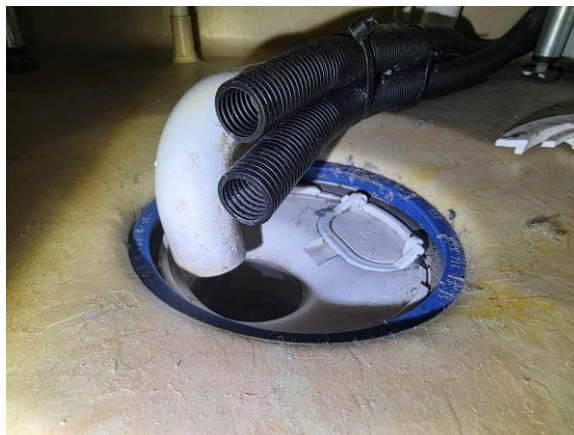
Golvbrunnen i tvättstugan. Klämringen har ej bottnat i brunssätet. Rör genomföringar i golv syns bakom golvbrunnen.
