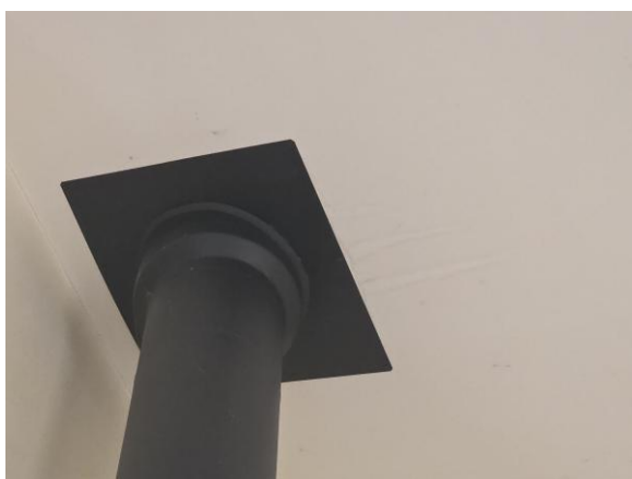
Spår av läckage/rinnmärken på innertak invid skorsten, i vardagsrummet.
