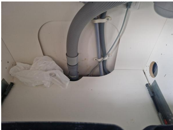
Det finns inget fuktskydd i botten av diskbänksskåpet.
