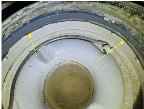
Brunnsmanschetten sticker fram under klämringen.
