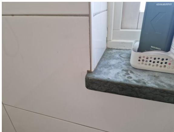
Badrum övre plan - Äldre fönsterbänk är kvar sedan renoveringen och oklart hur nytt tätskikt är monterat mot fönsterbänk.
