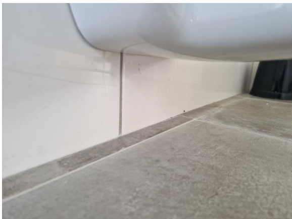
Inbyggd spolcistern till wc saknar läckageindikering.
