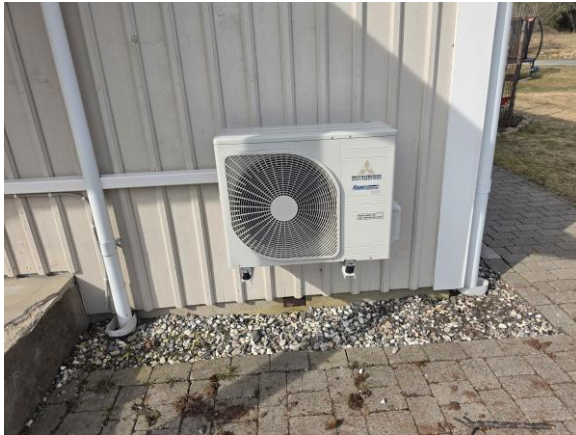
Kondensvatten leds inte bort från luftvärmepumpens utedel.
