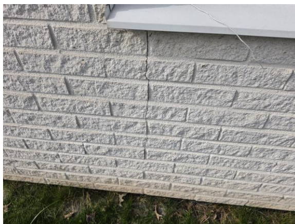
Spricka i fasad
