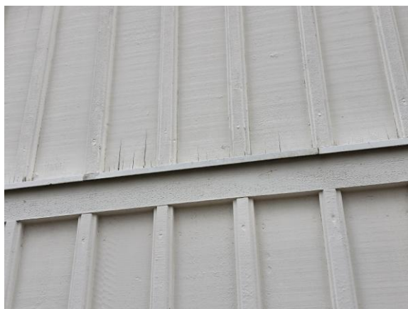
Torrspäckor förekommer i fasadpanelen.
