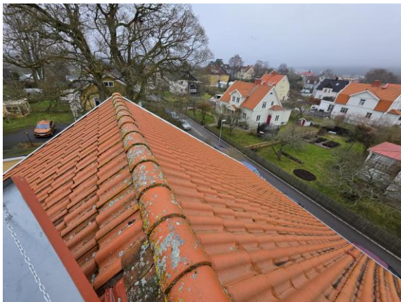
Vy yttertak – Begynnande mosspåväxt på takpannor
