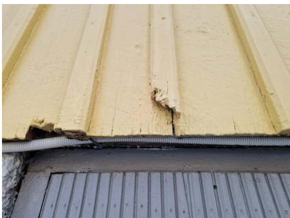
Lokala mindre rötskador i ändträ på fasadpanelen.
