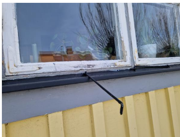
Målning/underhållsbehov på fönster
