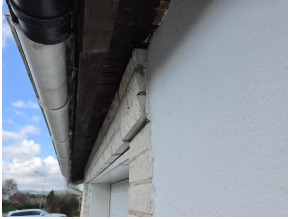
Murad tegelbalk över garageport buktar utåt
