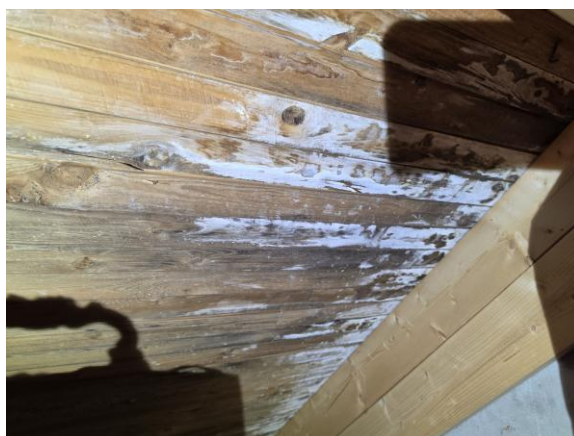
Fuktgenomslag på underlagstaket vind/förråd – se bilder/fuktmätning.
