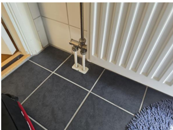
Rör genomföringar finns i golv i våtutrymmena.
