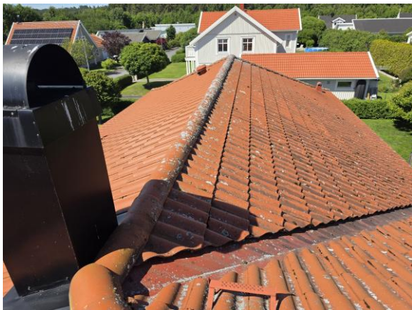
Vy över yttertaket – det förekommer lavpåväxt på takpannorna.
