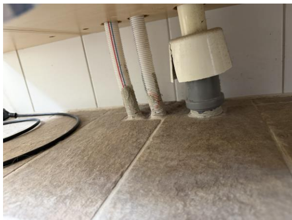
Rör genomföringar i golv i badrum.
