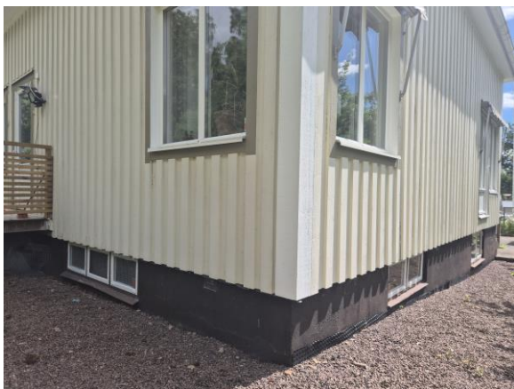
Tättningslist saknas på delar av platonmattan som sticker upp ovan mark.
