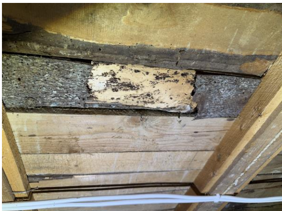
Spår av träskadeinsekter.
