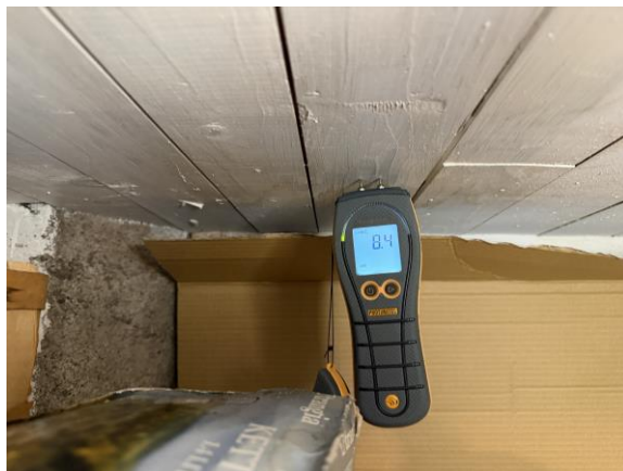
Fuktmätning i missfärgning i tak i matkällare. Torrt vid besiktningstillfället.
