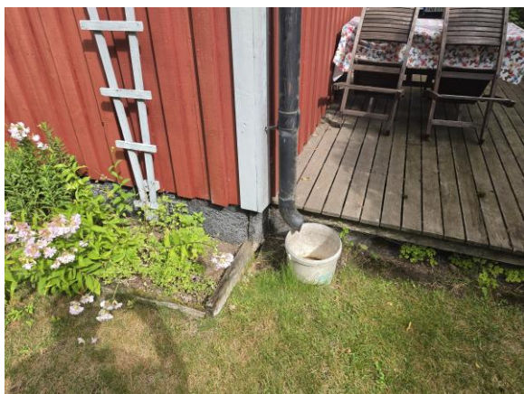
Regnvatten leds inte bort från stuprören.
