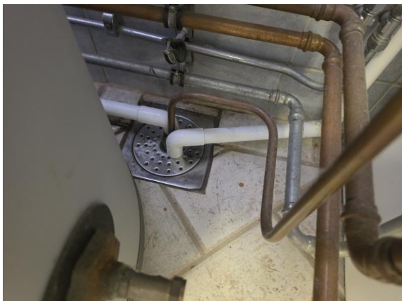
Tvättstuga - Det inte finns något tätskikt anslutet till golvbrunnen som också är placerad för nära väggen.
