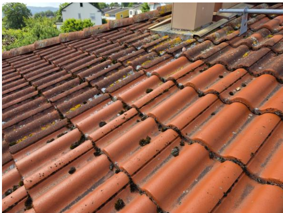
Begynnande mosspåväxt finns på takpannor
