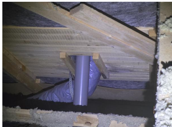
Lokala missfärningar/mikrobiell påväxt, på underlagstak av råspont invid takgenomföringar.
