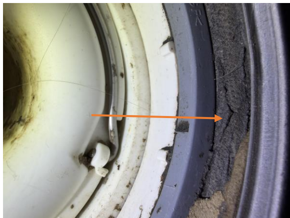
Spricka i brunnsmanschetten i wc/dusch.
