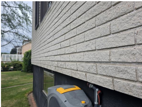
Nedre 3-4 skift buktar utåt. Bild på östra gaveln.
