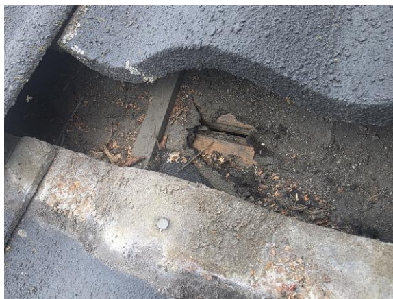
Närbild under takpanna, äldre otät underlagspapp. Stickprovskontroll från taklucka.
