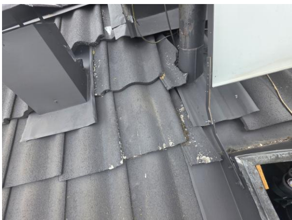
Äldre yttertak med målade takpannor. Notera pannor ur läge samt spruckna pannor.
