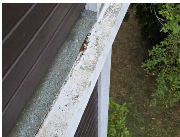
Plastmattan har börjat släppa från fotplåten.
