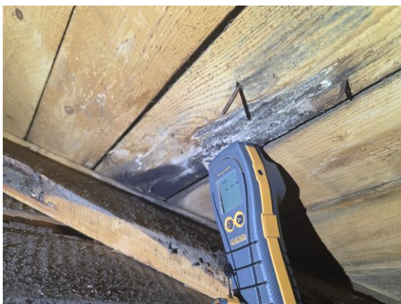
Fuktmätning i fuktbläck under vinkelrännan ovanför terrassen. Fuktkvoten uppmättes till <8% vilket är under kritisk gräns (17%) för mikrobiell tillväxt.
