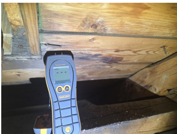
Fuktmätning i fuktbläck i direkt anslutning till takluckan. Fuktkvoten uppmättes till <8% vilket är under kritisk gräns (17%) för mikrobiell tillväxt.
