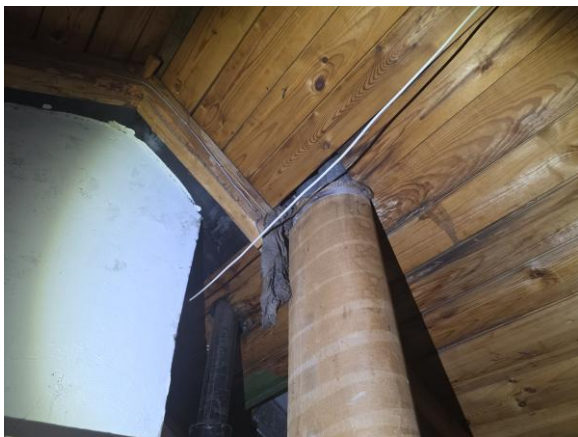
Fuktbläckar/missfärgningar på underlagstak.
