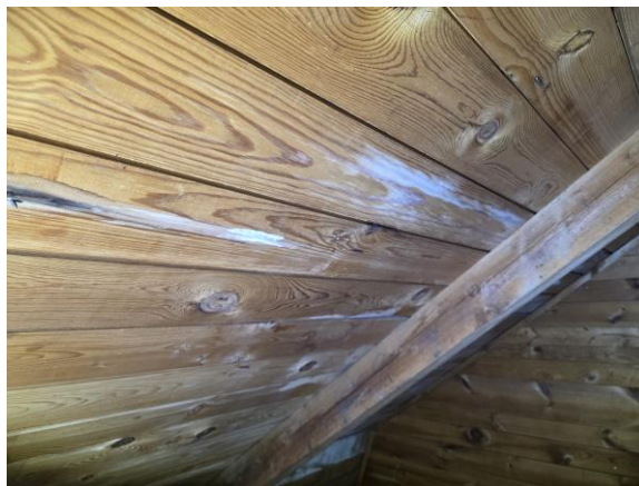
Mikrobiell påväxt på underlagstak.
