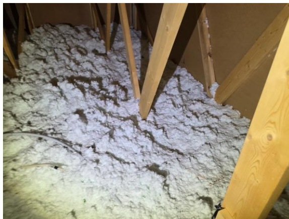
Isoleringen ligger ojämnt fördelat i delar av vindsbjälklaget.
