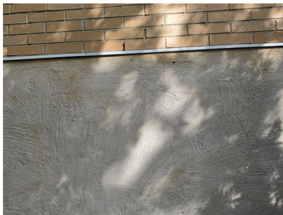
Sprickor förekommer på grundmuren.
