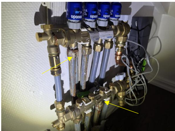
Visar fördelare till golvvärme i allrum källare. Ärjade kopplingar förekommer.
