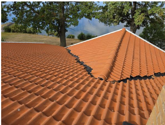
Vy över ytterstaket. Takpannor ojämnt kapade i ränndalar,
