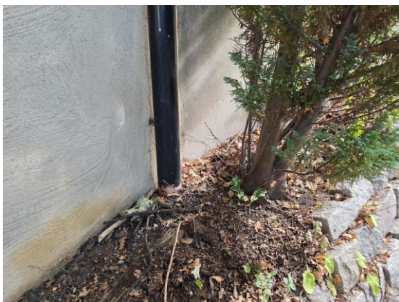
Växer/träd förekommer intill huset. Och det saknas renssilar på delar av stuprören.
