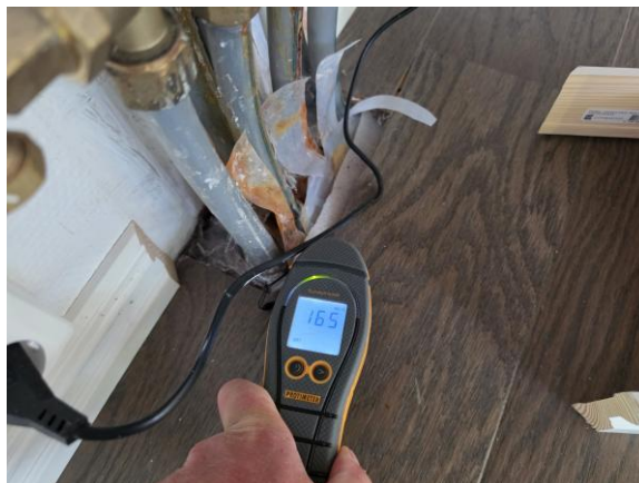
Vid fuktindikering noterades inga avvikelser runt fördelare till golvvärme.
