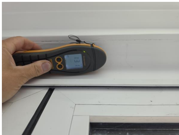
Missfärningar på tak/vägg ovanför uterumspartier. Vid fuktindikering noterades inga avvikelser. Gammal skada från terrass som är åtgärdad.
