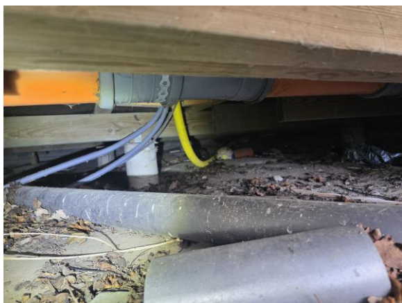
Vy in i plintgrunden under gästhuset, från fasadliv. Notera organiskt material på mark samt oisolerade vattenledningar.
