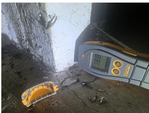
Trästolpe ingjuten i betonggolvet. Fuktkvoten uppmättes till 19% vilket är över kritisk gräns (17%) för mikrobiell tillväxt.
