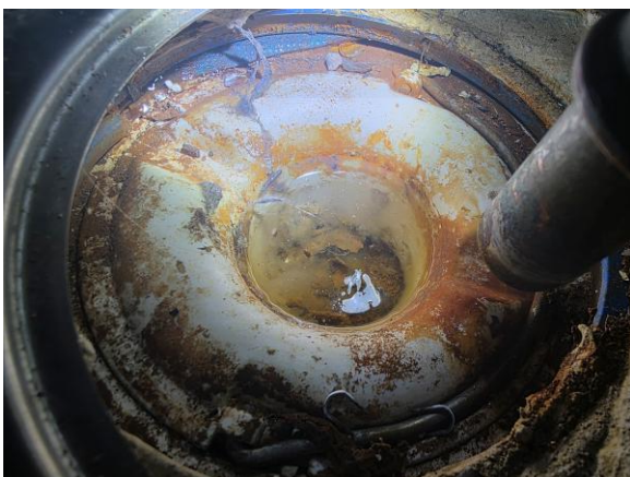
Klämring ej bottnat i brunnssätet och manschetter sticker fram under klämring, tvättstuga/apparatutrymme.
