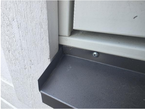
Mindre otätheter vid fönsterbleckens gavlar/uppvik.
