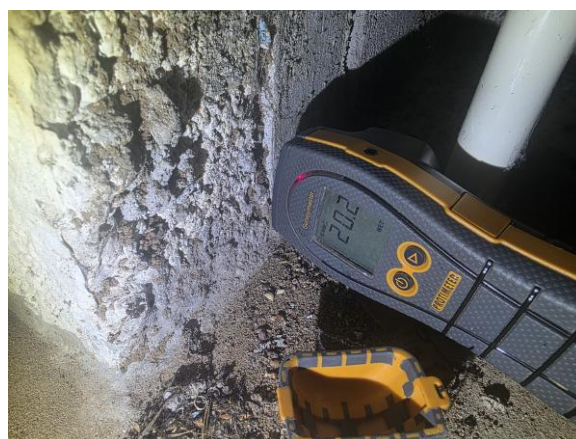
Trästolpe ingjuten/inmurad i vägg. Fuktkvoten uppmättes till 20% vilket är över kritisk gräns (17%) för mikrobiell tillväxt.
