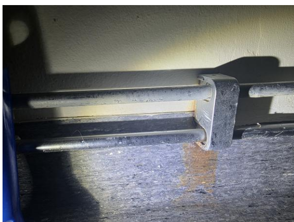
Tätskikt på vägg överlappar ej golvmattans uppvikt på vägg. Dusch/wc i gästhuset.
