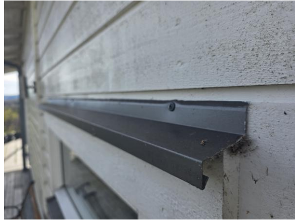
Överbleck utanpå fasaden.
