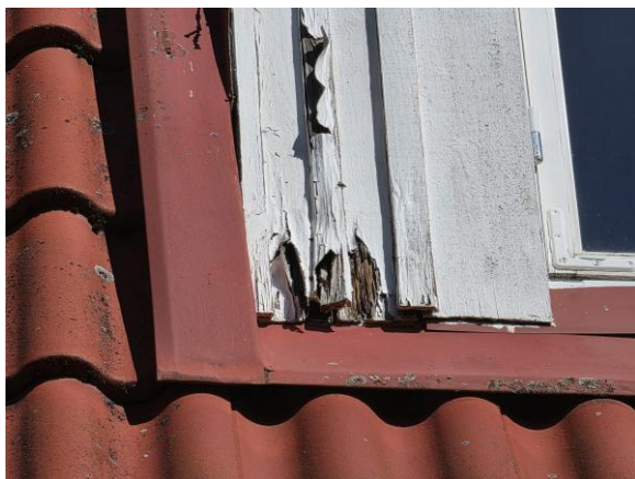
Mindre brötskador förekommer på fasadpanelen fönster på övre plan.
