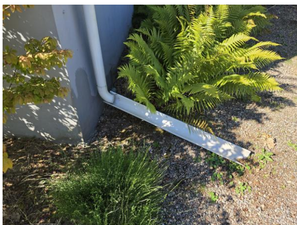
Dagvatten släpps intill huset.
