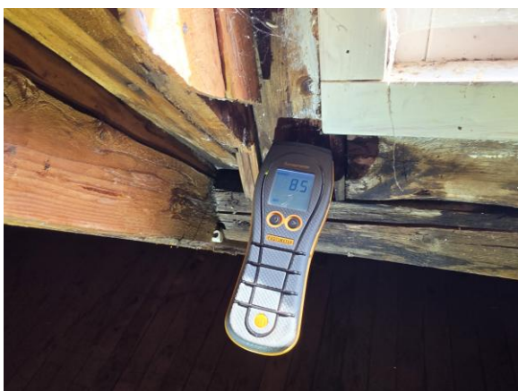
Spår av läckage noterades på underlagstaket på vinden. Vid fuktkvotsmätning noterades inga avvikelser.
