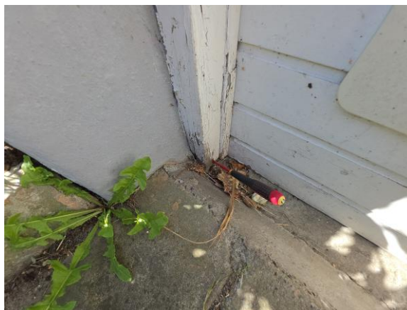
Rötskador finns i källardörrens karm
