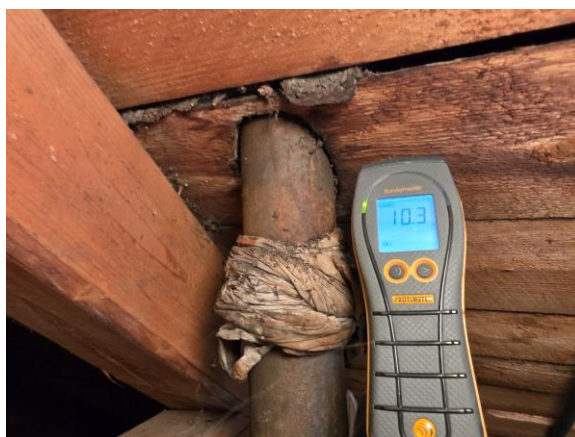
Spår av läckage noterades på underlagstaket på vinden. Vid fuktkvotsmätning noterades inga avvikelser.
