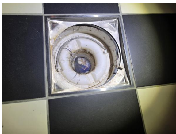
Brunnsmanschett sticker ut under klämringen i badrum i källare.
