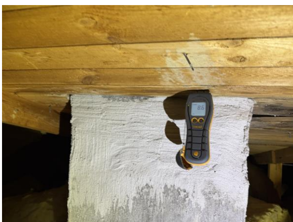
Fuktmätning utförd i fuktfläck vid murstock pånockvind. Torrt vid besiktningstillfället.
