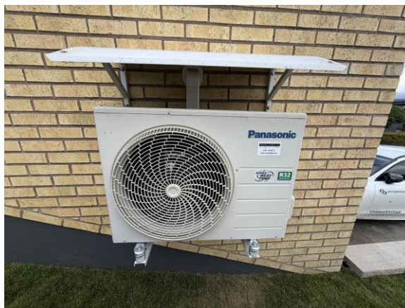
Spillvatten från luft/luftvärmepump släpps intill hus.
