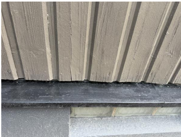
Underhåll/målningsbehov av träfasad vid uteplats.
