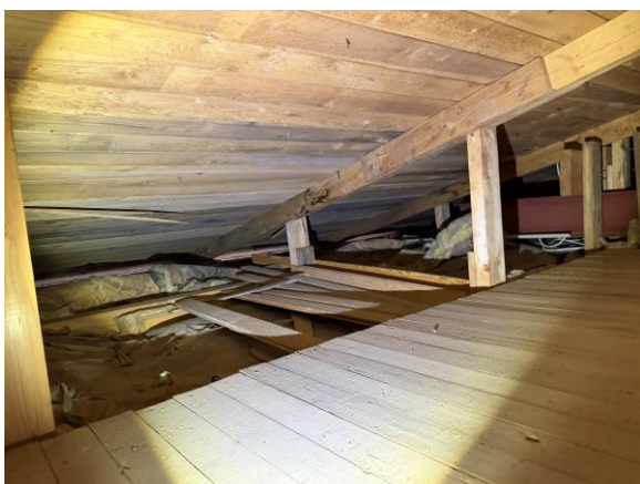
Mindre mikrobiell påväxt på underlagstak pånockvind.
