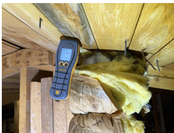
Fuktmätning i fuktfläck på underlagstak pånockvind. Torrt vid besiktningstillfället.
