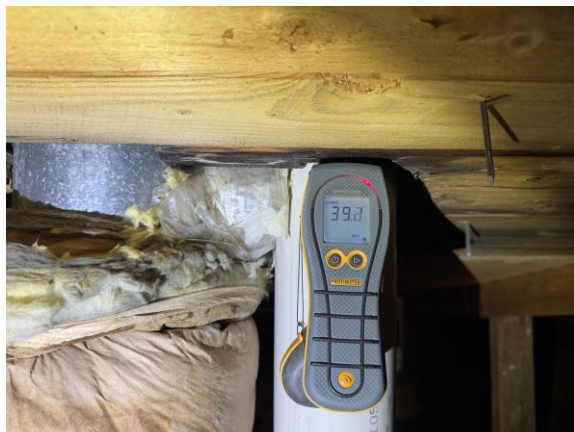
Fuktmätning i fuktfläck vid avluftare pånockvind. Uppmättes till över kritisk gräns.
