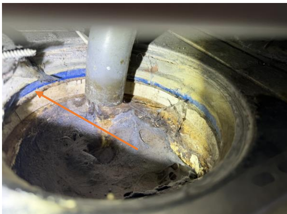
Mindre otätheter mellan plastmatta/klämring i golvbrunn i badrum.
