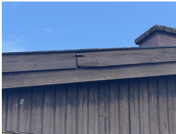
Rötskador i vindskivor.
