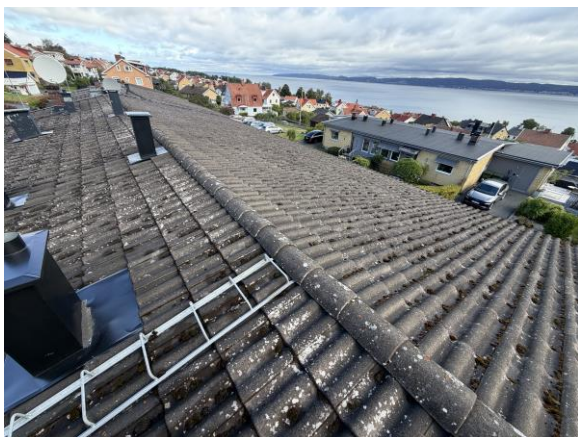
Vy från tak/mossa på takpannor.
