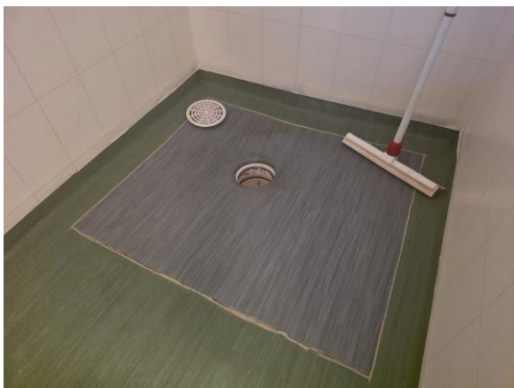
Dellagning på golv i dusch/tvättstuga. Mattan har släppt i svetsfog, från golv samt vid anslutningen till brunnen.
