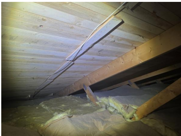
Mikrobiell påväxt på underlagstaket.
