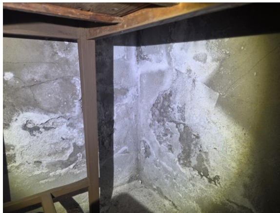
Fuktgenomslag i källarutrymmen.
