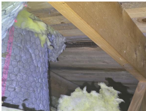
Lokala spår av läckage, fuktfläckar på underlagstak.
