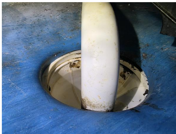
Våtrumsmattan har släppt vid anslutningen till golvbrunnen i badrummet.
