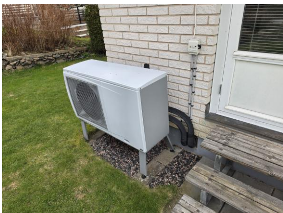
Kondensvatten leds inte bort från luftvärmepumpens utedel.
